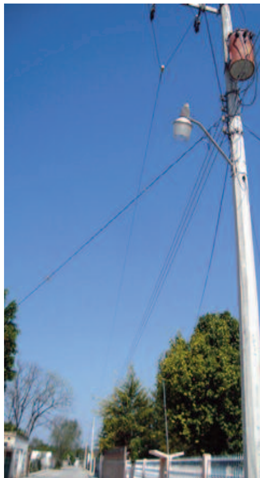
En días pasados los pandilleros causaron daños al alumbrado público.
